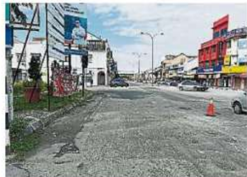
道路因地下水管不断破裂, 导致雪州水务管理公司需派人将道路挖开维修水管, 不料不出几天, 道路又现坑洞。(档案照)
