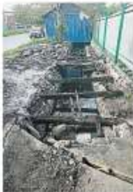
非法食檔衍生許多衛生問題，垃圾和油漬甚至被丟進溝渠。
